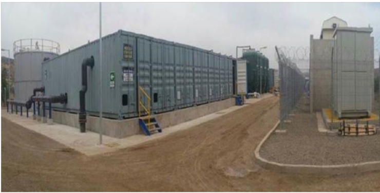
Vista de los contenedores del proceso de nanofiltración de la planta.
